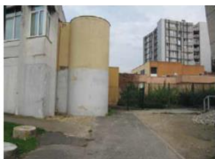
Des espaces dégradés entre l'espace Mauriac et le gymnase Lemarchand
